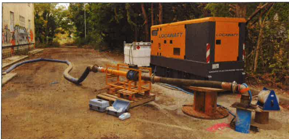
Photographie 4 : dispositif de pompage
